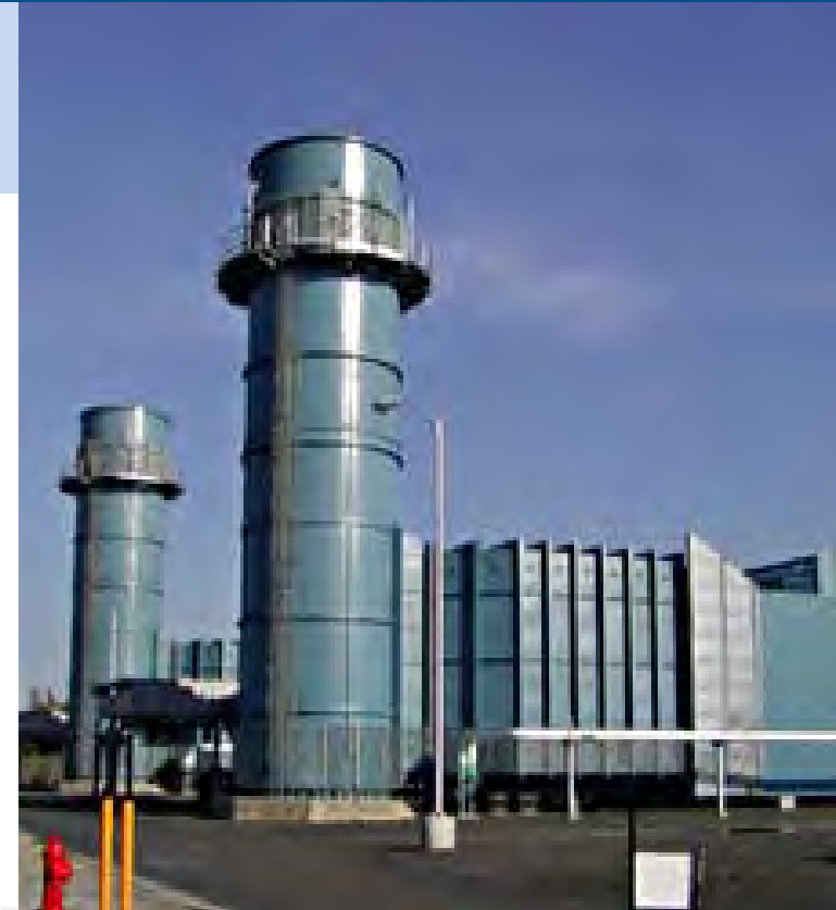
Chimeneas de Escape con Silenciadores Commonwealth diseño y construyó tres (3) Chimeneas de escape de 23m de altura con silenciadores acústicos, para una estación de alta demanda en un área densamente habitada con estrictos requerimientos de control de ruido.
