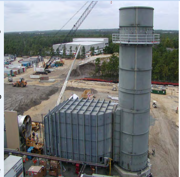
Instalación de Panel Silenciador Commonwealth proporciona servicios de llave en mano para el diseño y construcción de nuestros sistemas de silenciadores.
