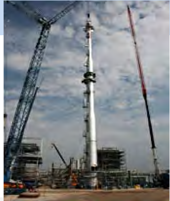
Montaje de Chimenea de Acero Commonwealth diseñó esta chimenea de pared doble y de 80m de altura para el Proyecto PTTAR Clean Fuel en Tailandia. Esta fotografía fue tomada durante el montaje.
