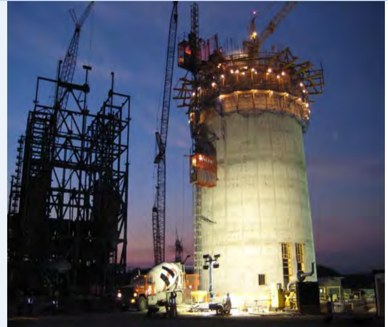
Vista de trabajos nocturnos durante la construcción de una chimenea de 120m de altura para la Comisión Federal de Electricidad en México.
