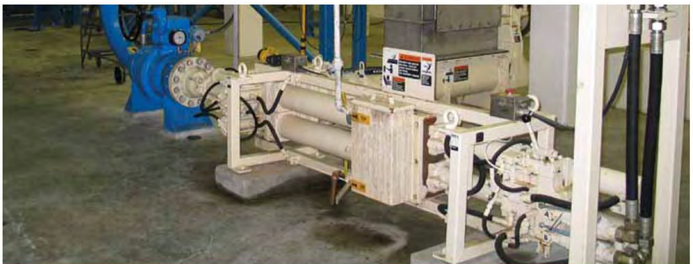
Modelo original da Schwing Bioset KSP 17V(K) com parafuso alimentador SD250 que continuará em serviço como reserva da nova bomba.
