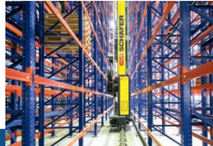
Automatisert høyreolager med rundt 5 300 palleplasser.
