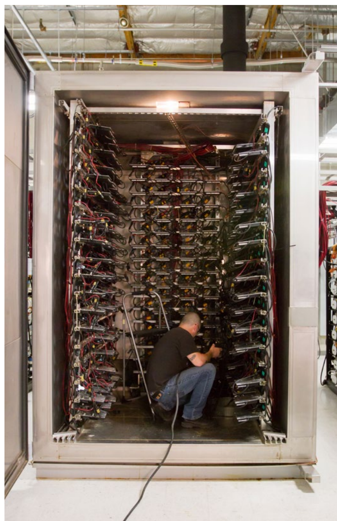
Enphase Test Centre
