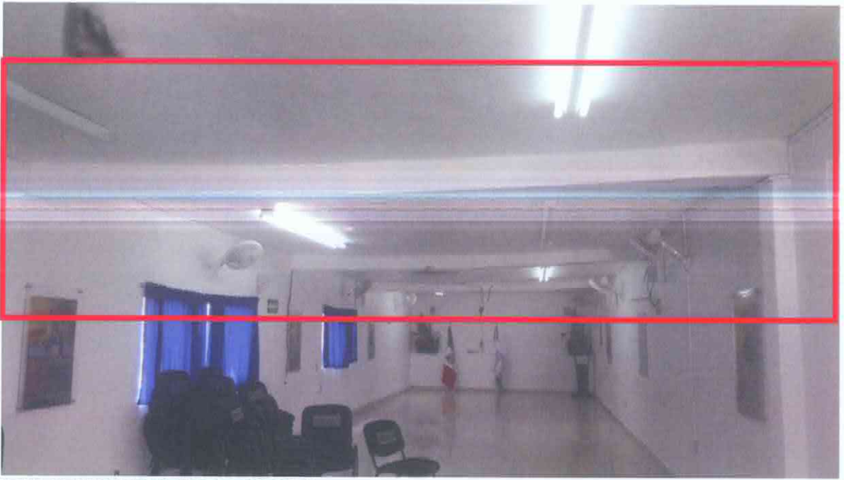
AREA RESTRINGIDA (FUERA DE USO)
