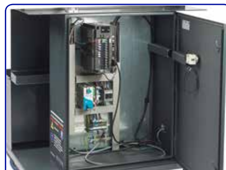
Quadro elettrico sigillato che contiene tutti i comandi e i cablaggi NC
