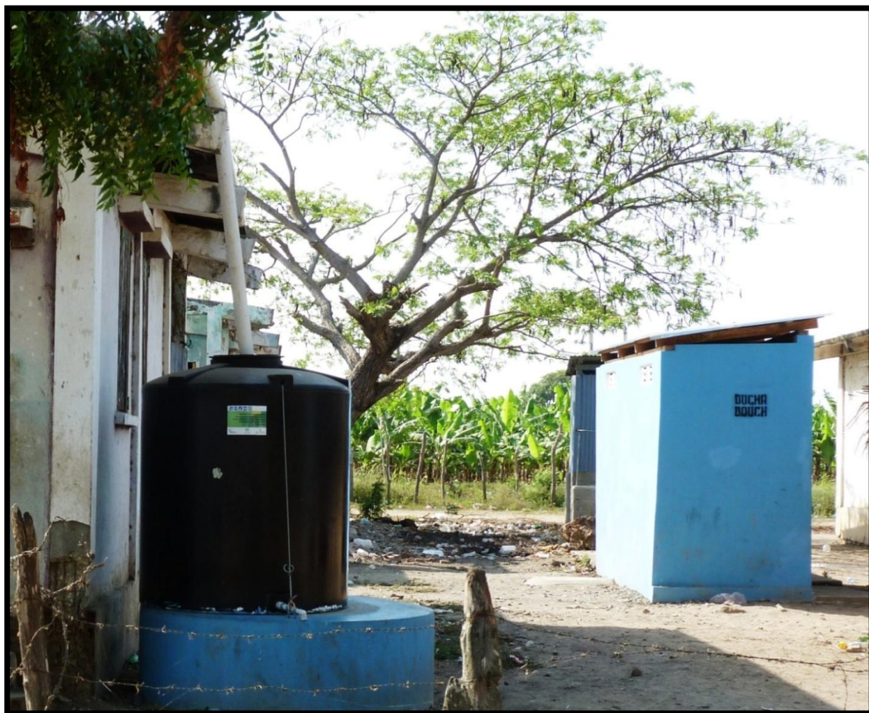
[Instalaciones creadas con el proyecto en la comunidad de Juliana: tinaco con sistema de recogida de agua de lluvia; letrina abonera y duchas. Fotografía: Marianna Cammerinesi]
