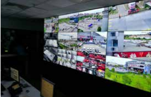
Centro de Control de la Cúpula de Sinan Erdem
