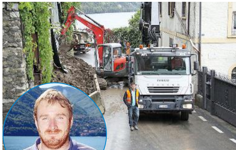
CANTIERE FERMO La frana che provoca parecchi disagi da mesi e il sindaco Roberto De Angeli
