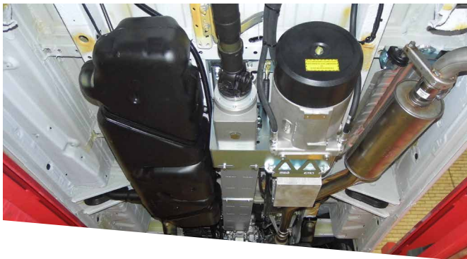
Prima (sopra) e dopo l'installazione di un sistema formato da compressore e generatore sotto il telaio di un furgoncino Thermo King Berlin Transportkälte GmbH.
